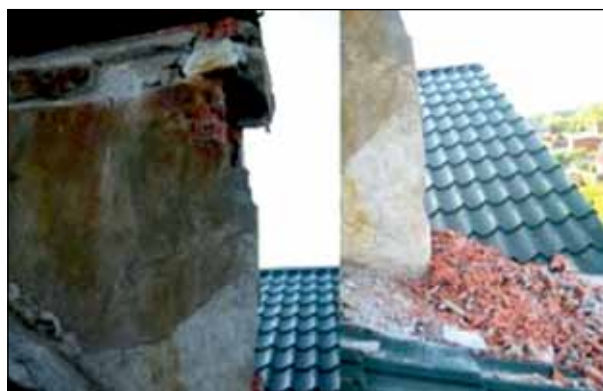
На этих фото видно, как разрушается кирпичная труба из-за конденсата
